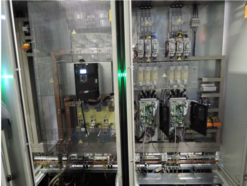
Foto del nuovo quadro elettrico contenente gli azionamenti SAEL DC ONE
