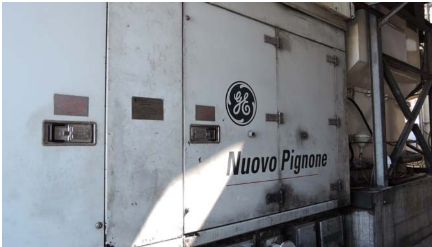
Turbine and alternator Turbogas Nuovo Pignone, Cartiera Vignaletto
