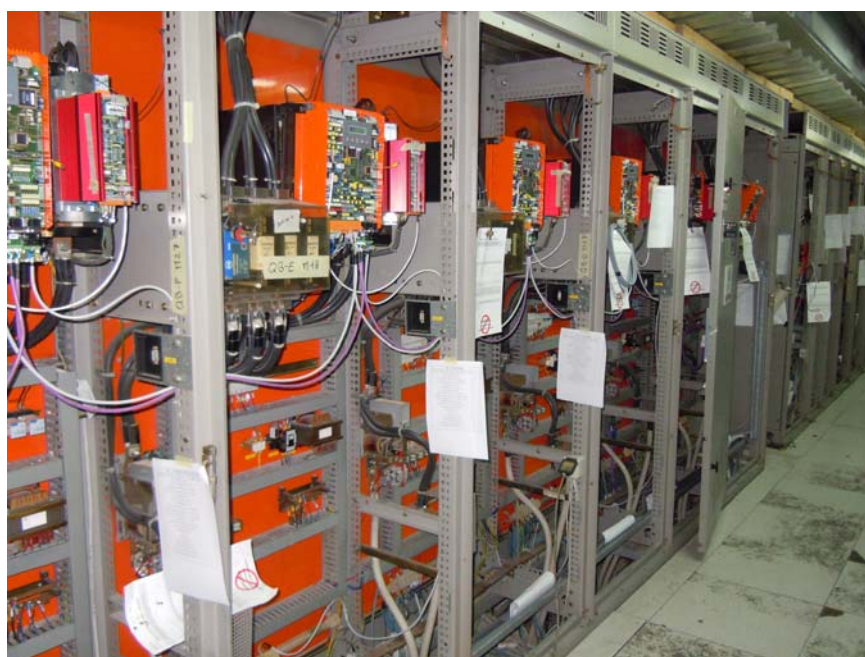
Drive DC esistenti in cartiera dopo la trasformazione con REBORN
