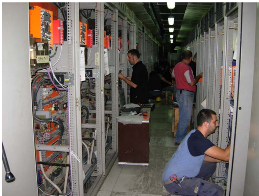
cablaggi elettrici effettuati direttamente da SAEL in cartiera
