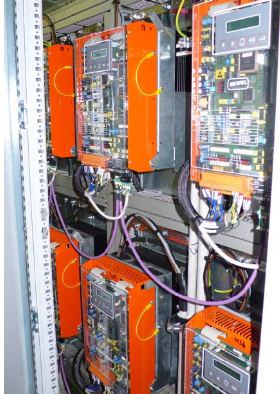
Alcuni degli inverter che costituiscono il comando swzionale di macchina 1
