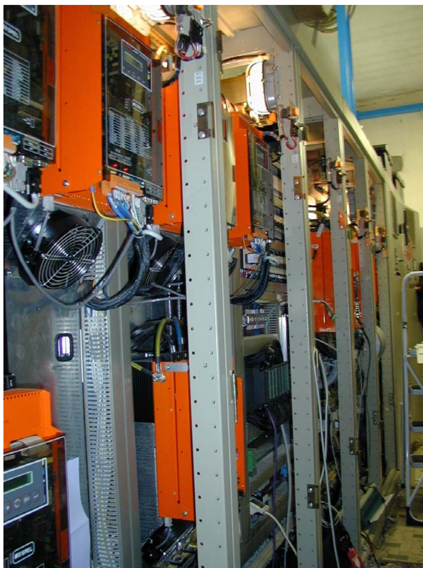
VEDUTA DEGLI INVERTER "INTELLIGENT DRIVE SAEL"
