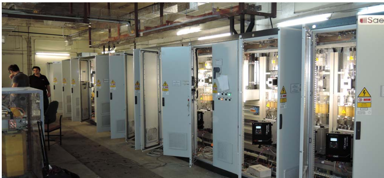
MEL sala quadri, gli azionamenti sono stati cablati fronte e retro per diminuire gli spazi.
