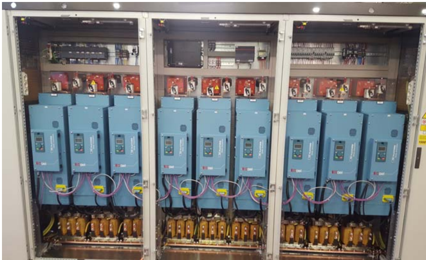
9 inverters raffreddati ad acqua da 400 KW installati in appena 3 mt di armadio, comando di una Talpa -ONE DRIVE WATER-
