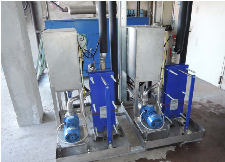
Gli scambiatori acqua-acqua con mandata diretta dal pozzo che raffreddano inverters e quadri elettrici
