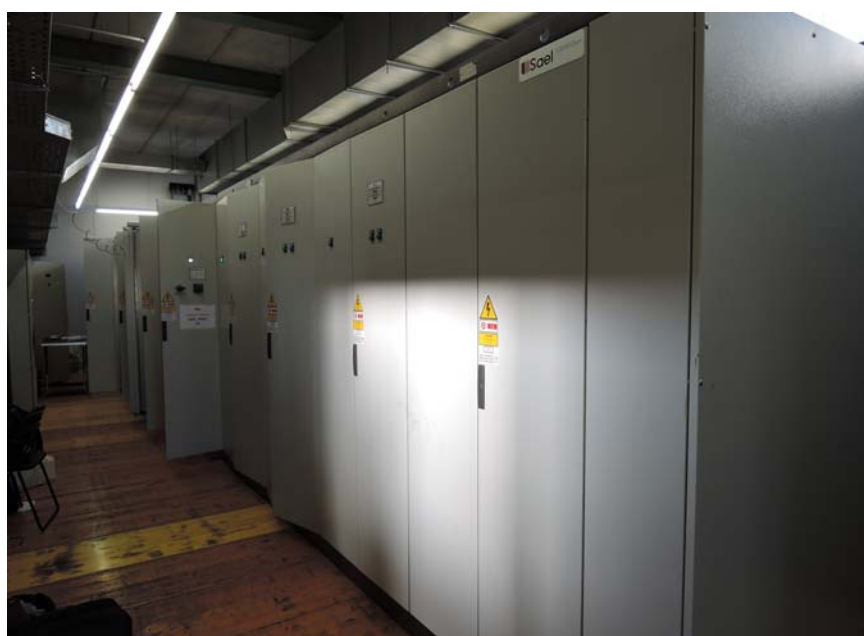
Quadro elettrico zona secca con inverters cablati su doppio fronte e raffreddamento ad acqua
