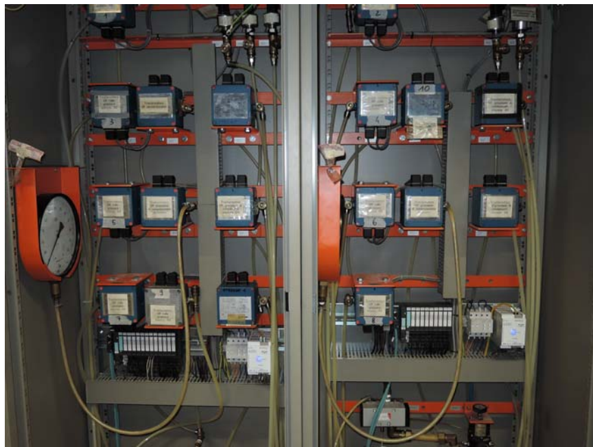
LDS, il sistema di controllo di pressione rulli esterni, interni, ammortizzatori, pareggiatori e delle stazioni portabobine; ET200S.
