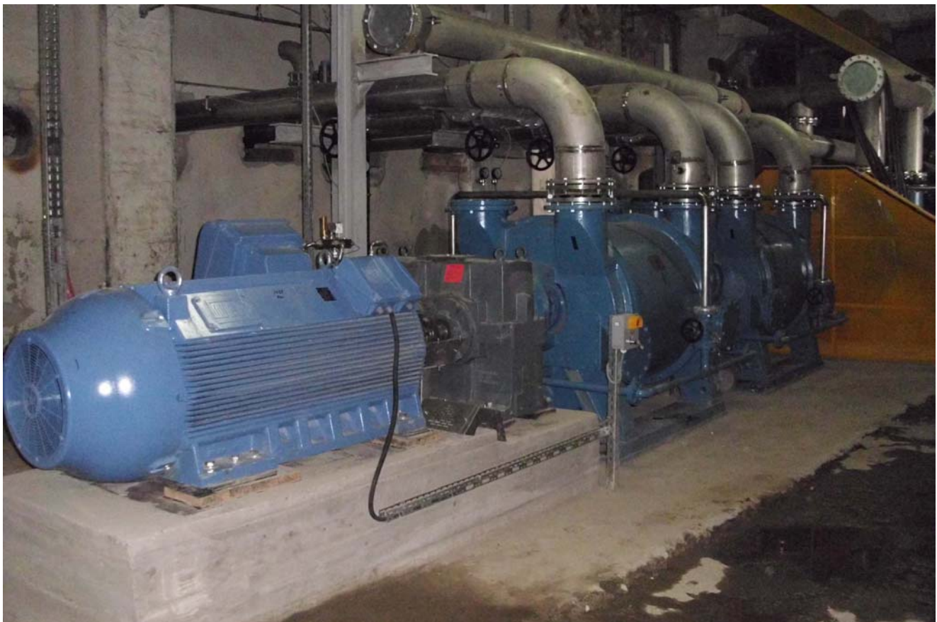
Tipica installazione Cutes Europe con pompe collegate in serie per condizionamento feltri
