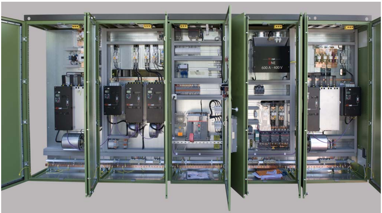
Quadro elettrico di comando pompe con inverter della serie esclusiva "PLATFORM ONE" drives
