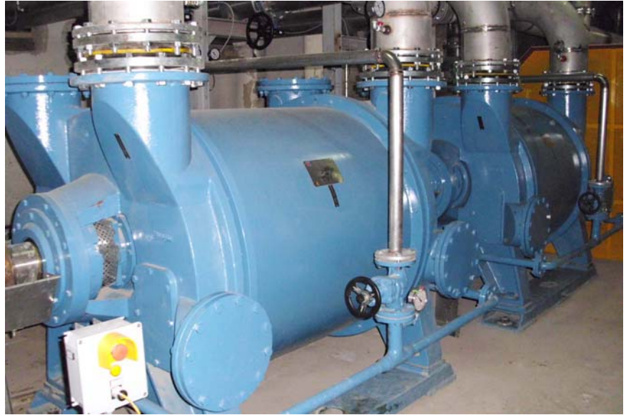
Particolare dell'alimentazione acqua anello liquido con gestione del ciclo chiuso
