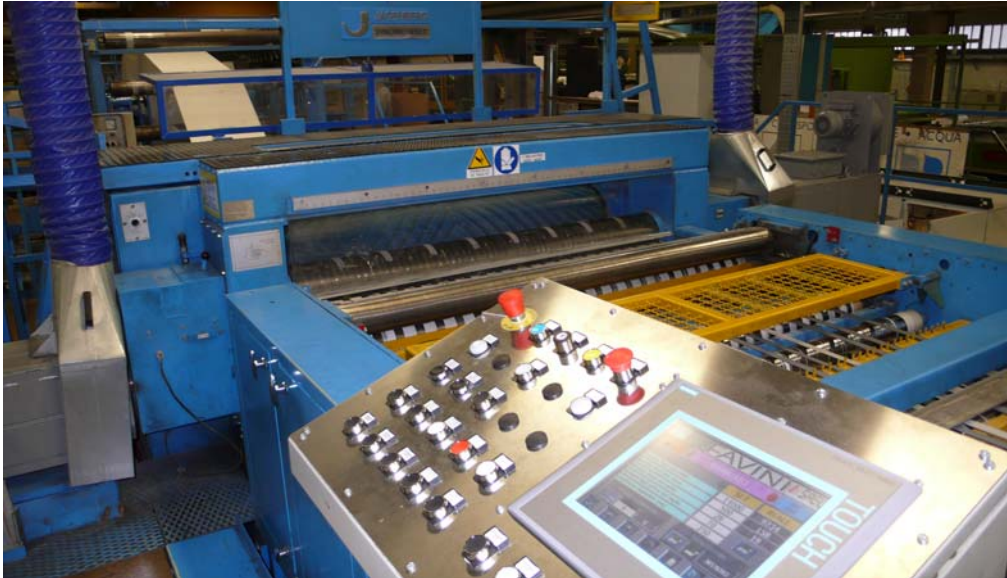
Il pulpito principale di comando ricostruito e semplificato per una conduzione più ergonomica e moderna; il pulpito contiene una videotastiera touch screen.
