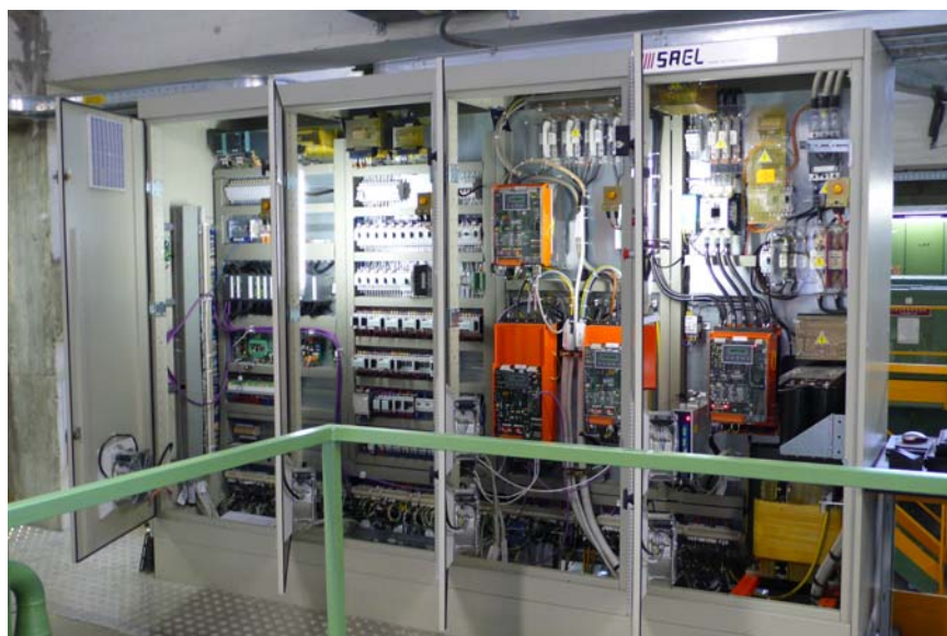
Quadro elettrico Jagemberg AS 16, Cartiera del Garda, Aprile 2007
