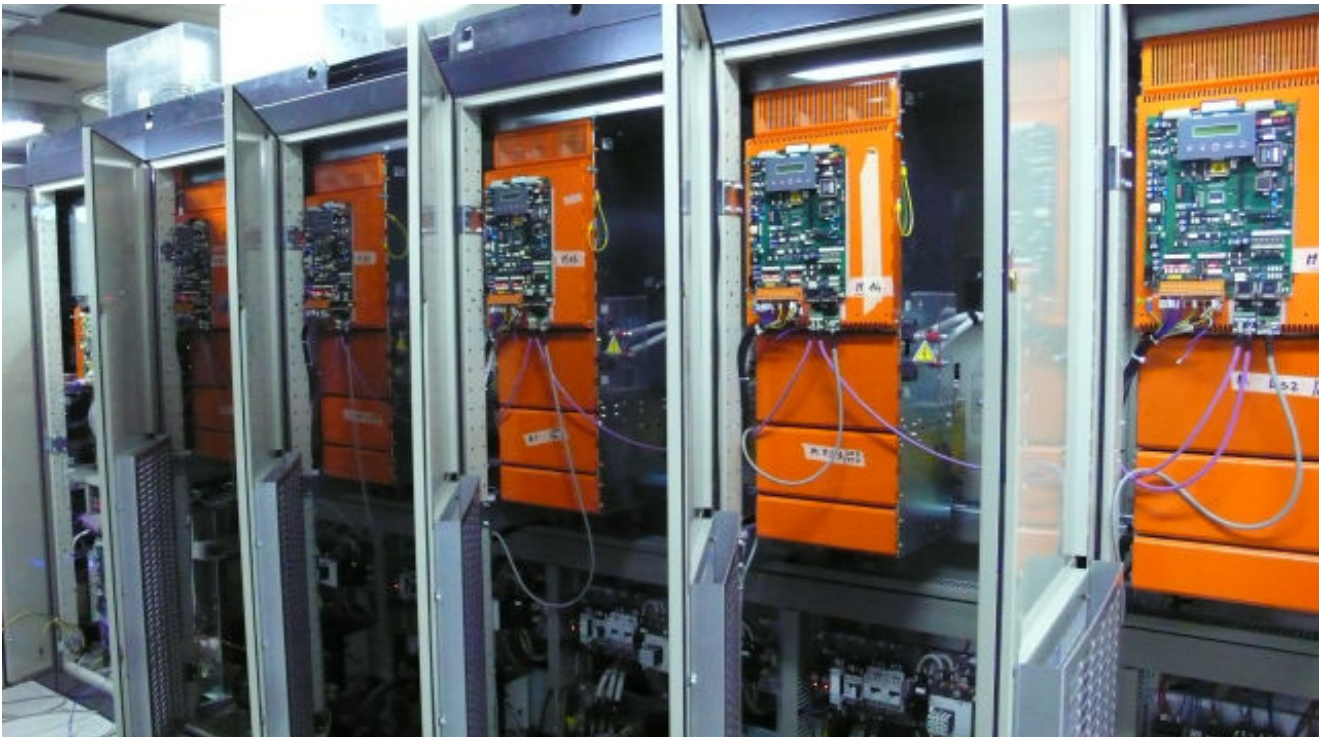
Quadro inverters 1° e 2° seccheria, cartiera di MANTOVA, marzo 2007
