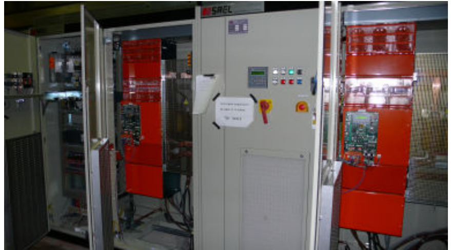
QUADRO ELETTRICO DELLA FUN PUMP DA 1060Kw
