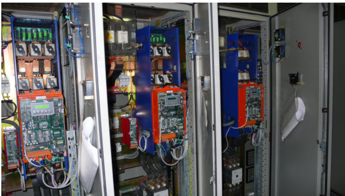
Drive DC esistenti in cartiera dopo la trasformazione con REBORN
