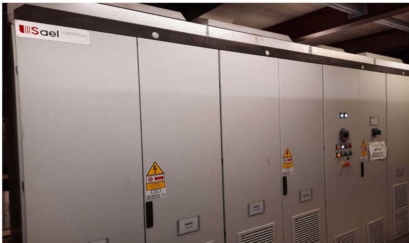
QUADRO DI COMANDO MACCHINA CONTINUA ESEGUITO IN DOPPIO FRONTE PER CONTENERE LE DIMENSIONI
