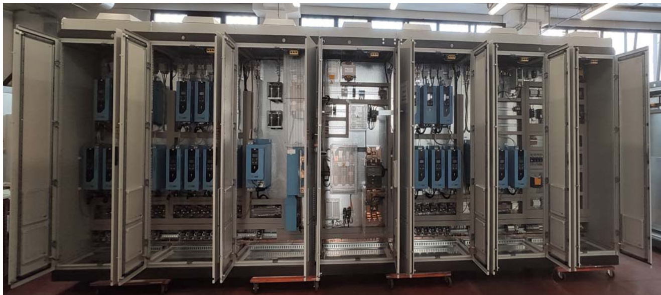
VISTA FRONTALE QUADRO CON LA DISPOSIZIONE DEGLI INVERTER SU DOPPIO FRONTE
