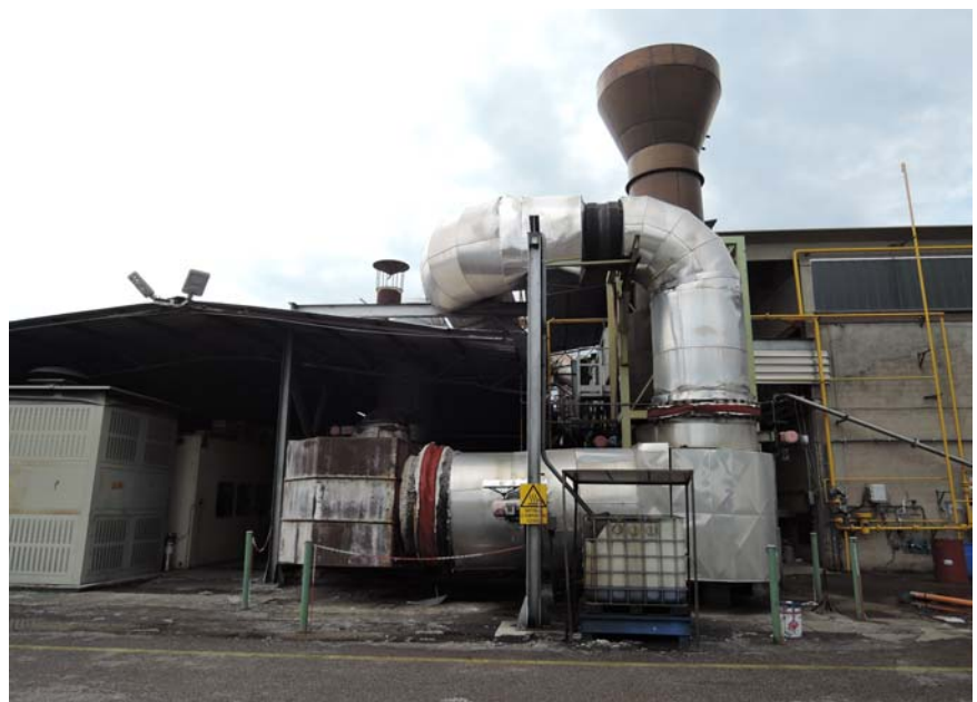
Foto globale del Turbogas ricostruito da 5 Mw della cartiera Vignaletto
