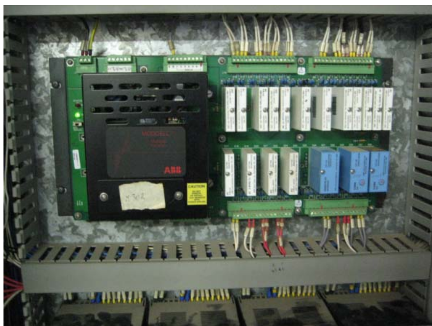
HARDWARE ABB MODCELL RIMPIAZZATO CON ET200S SIEMENS
