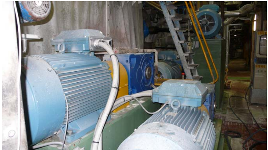
Vista zona comando perte umida dove sono stati sostituiti i vecchi motori DC con i nuovi AC comandati da inverter “ ONE DRIVE ”
