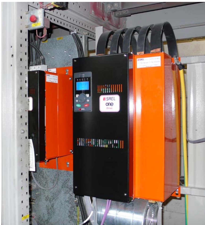
Gli “inverters ONE” della serie LONG LIFE, un prodotto studiato per la cartiera per garantire facile sostituzione in caso di guasto, semplice approccio per i tecnici elettronici e dotato di componenti a vita infinita.
