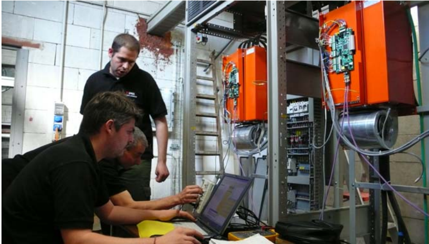
Collaudi dei drive “PLATFORM ONE” in cartiera, il sistema studiato per essere facilmente gestito dalla cartiera
