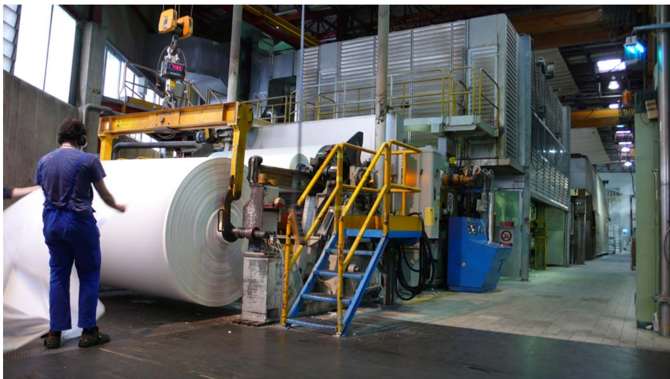
Zona POPE di macchina su cui è stata motorizzata in AC la parte umida, "PLATFORM ONE DRIVE" SAEI
