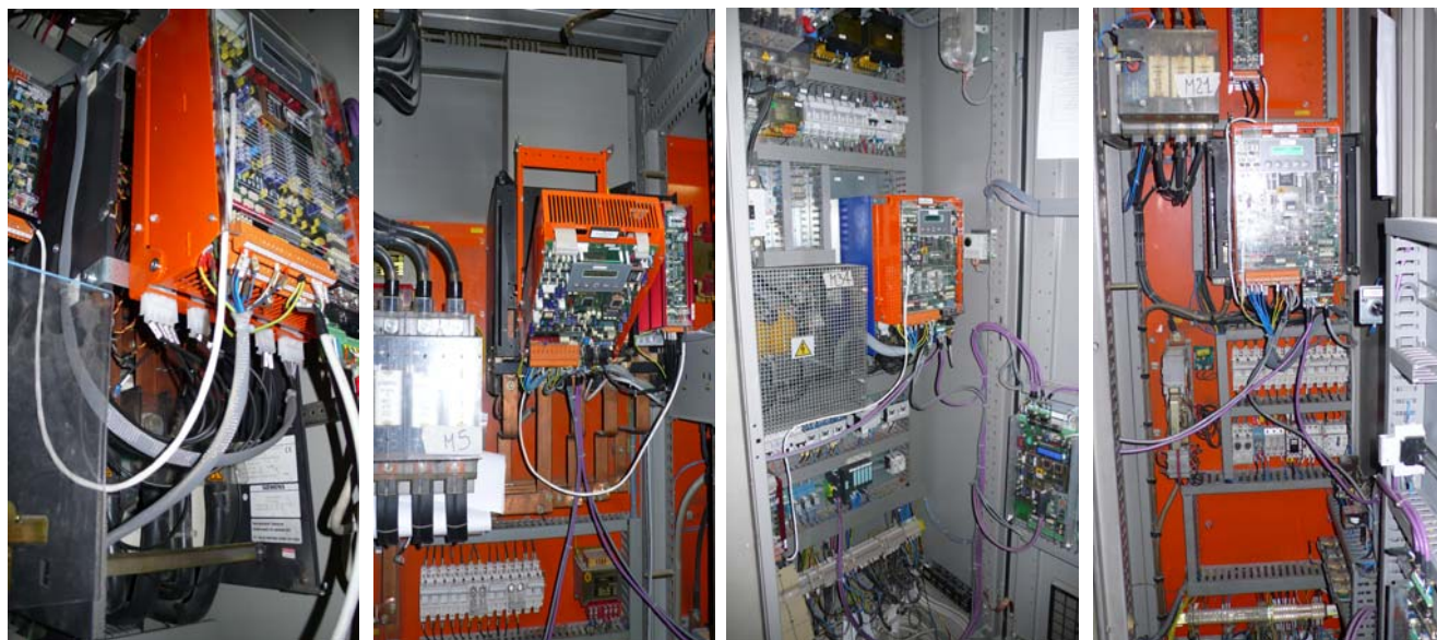
Vista di diversi azionamenti dopo il riassetto con il sistema “REBORN”
