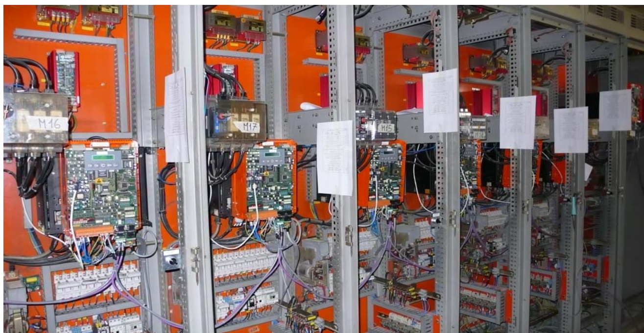
Foto di repertorio di vecchi quadri elettrici ripuliti e cablati con il sistema “REBORN” di SAEL.
