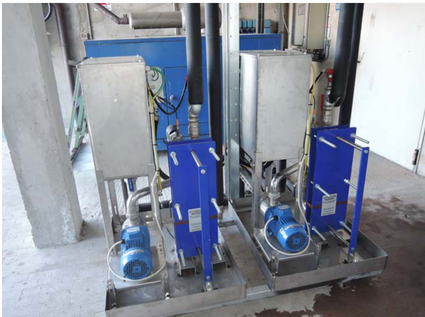
Scambiatori acqua-acqua con mandata diretta dal pozzo.
