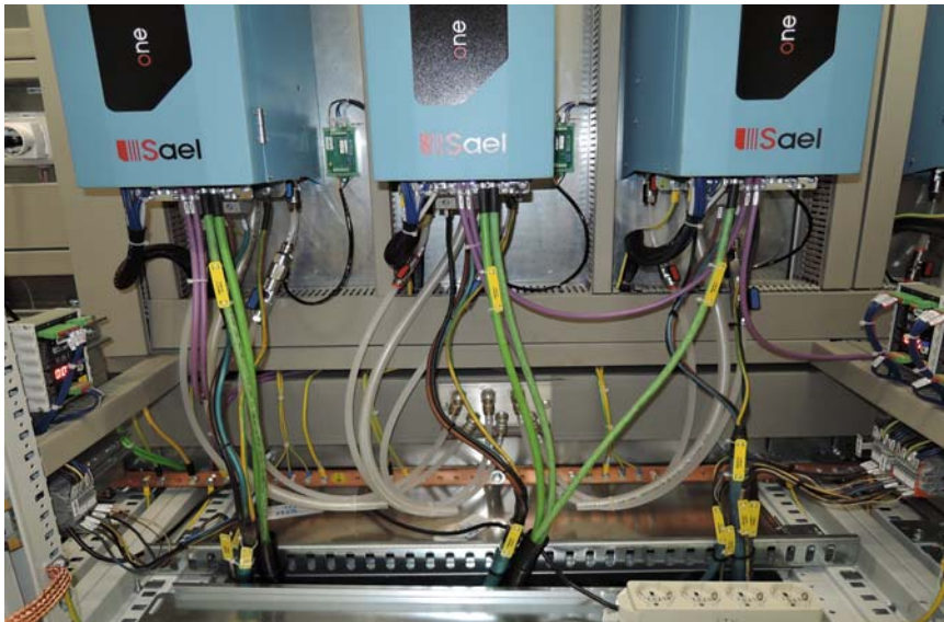
Quadro elettrico di comando sezionale con inverter della serie esclusiva "PLATFORM ONE" drives WATER
