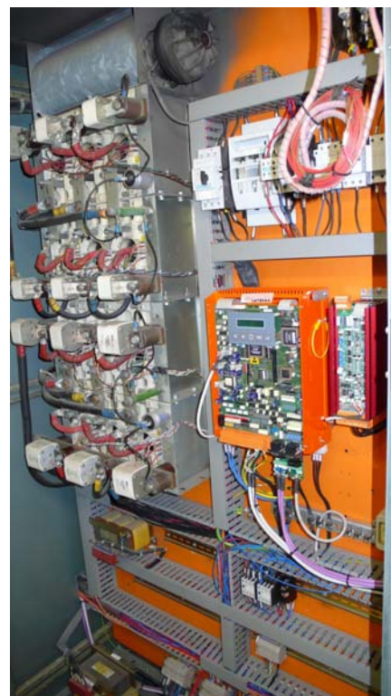
cablaggi elettrici "REBORN"
