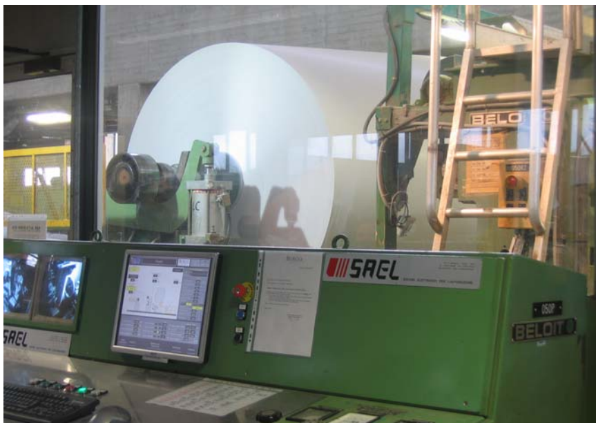
Pulpito di comando prima e dopo della modifica elettrica
