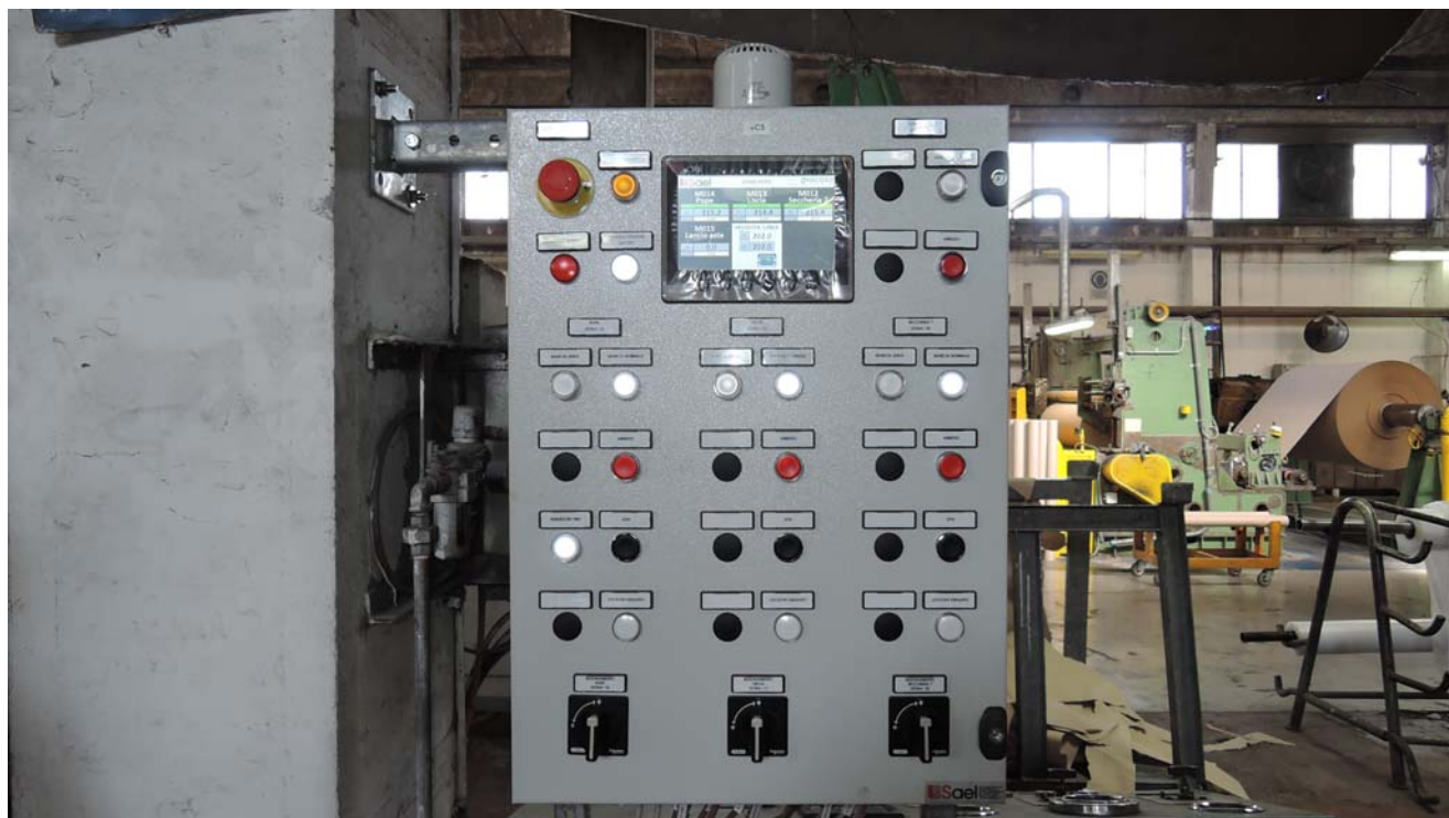
Cassette di gestione motori ridondanti al DCS- PLATFORM ONE DRIVE SAEL
