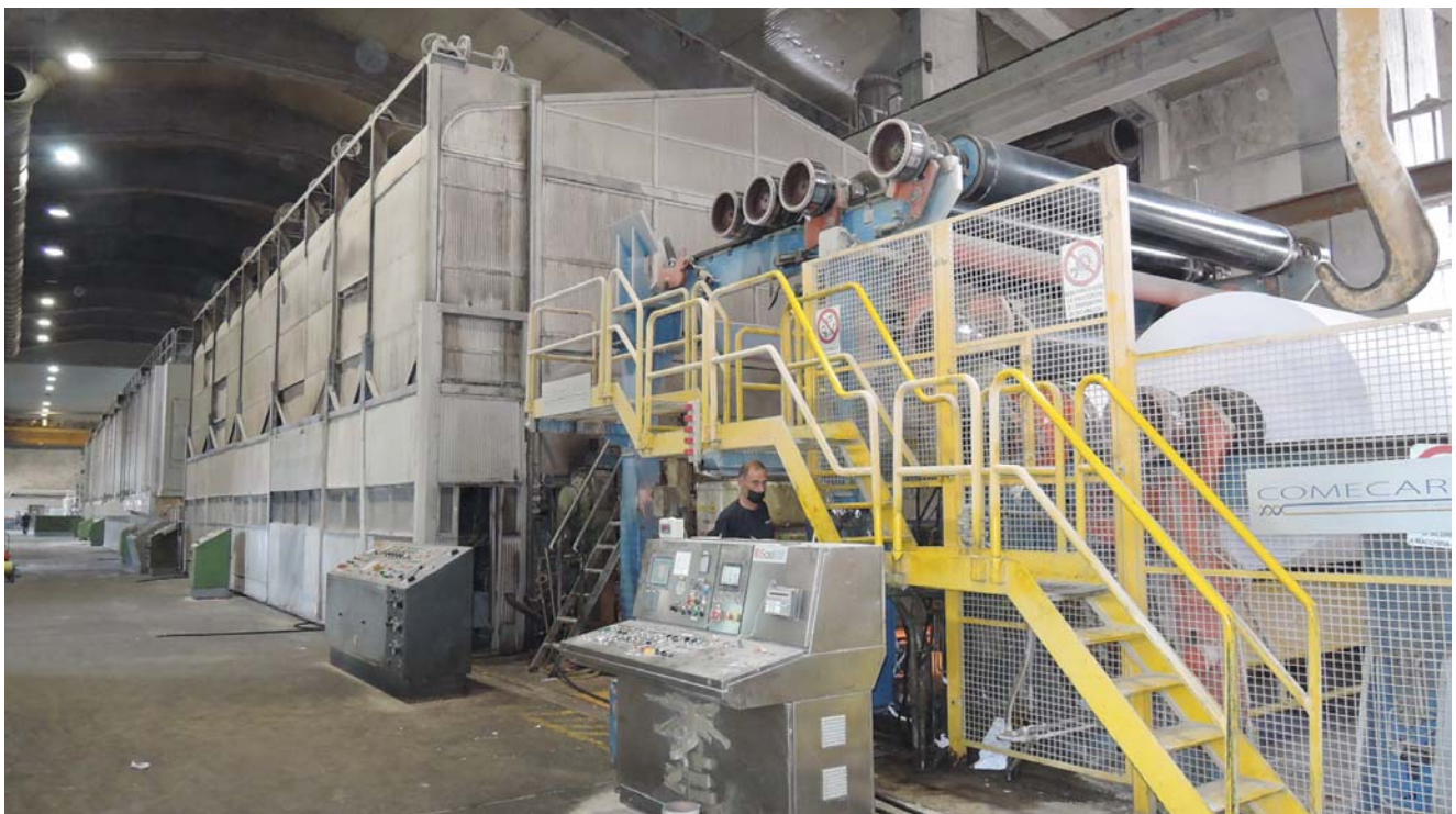
Vista zona secca MC1 stabilimento di TOLMEZZO ricostruita con PLATFORM ONE DRIVE
