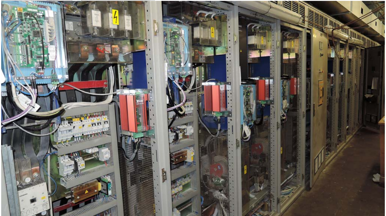
Vista della sala quadri durante le operazioni di cablaggio REEBORN PLATFORM ONE DRIVE
