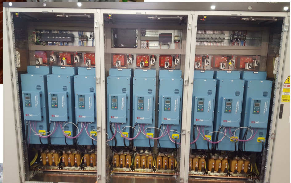
RIGHT - Multidrive cabinet: N° 9 motors x 400Kw driven
